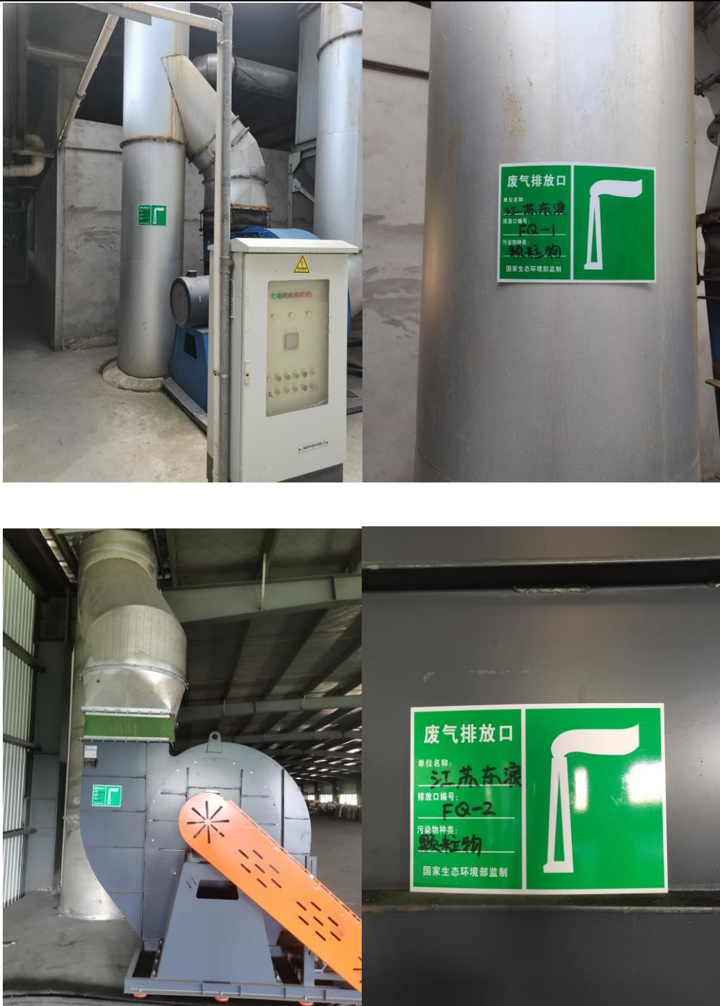
图 3-2 废气处理装置及排气筒
