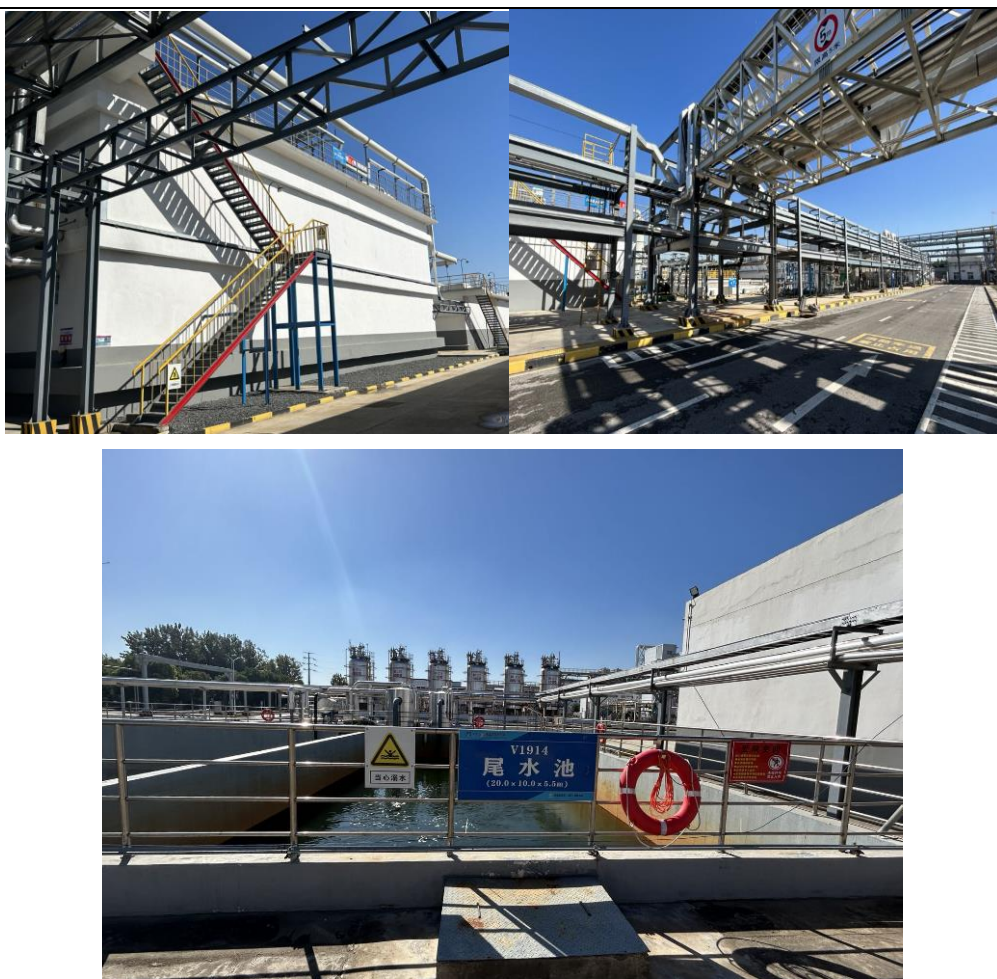
图 3-2 麦道废水处理站现场照片
