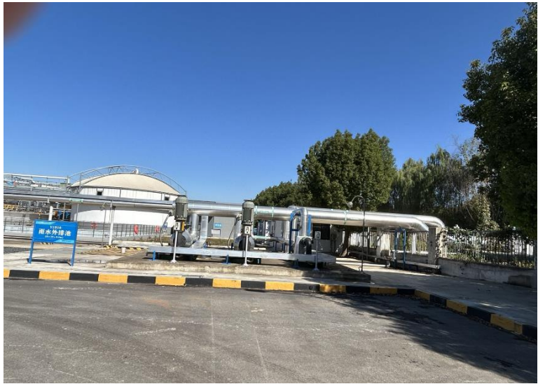
图 3-8 雨水排放口标志牌
