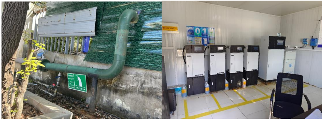
图 3-7 废水总排口标志牌
